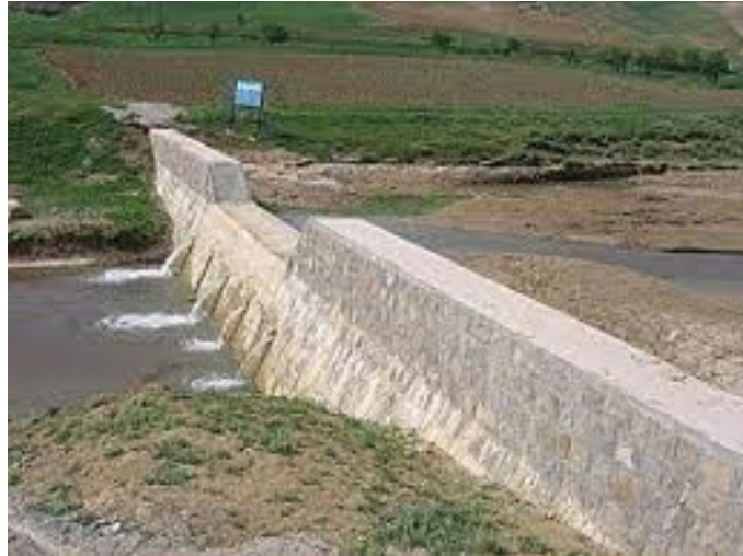
شکل-۳- احداث بند سنگ و ملاتی با سرریز ذوزنقه ای در منطقه مورد مطالعه
