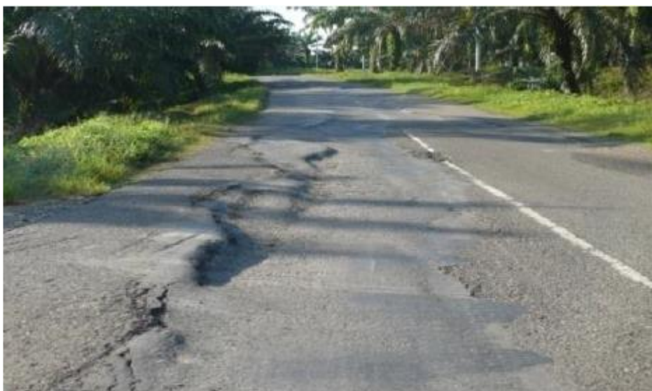
شکل ۸: ترک های ناشی از فرونشست آسفالت جاده
